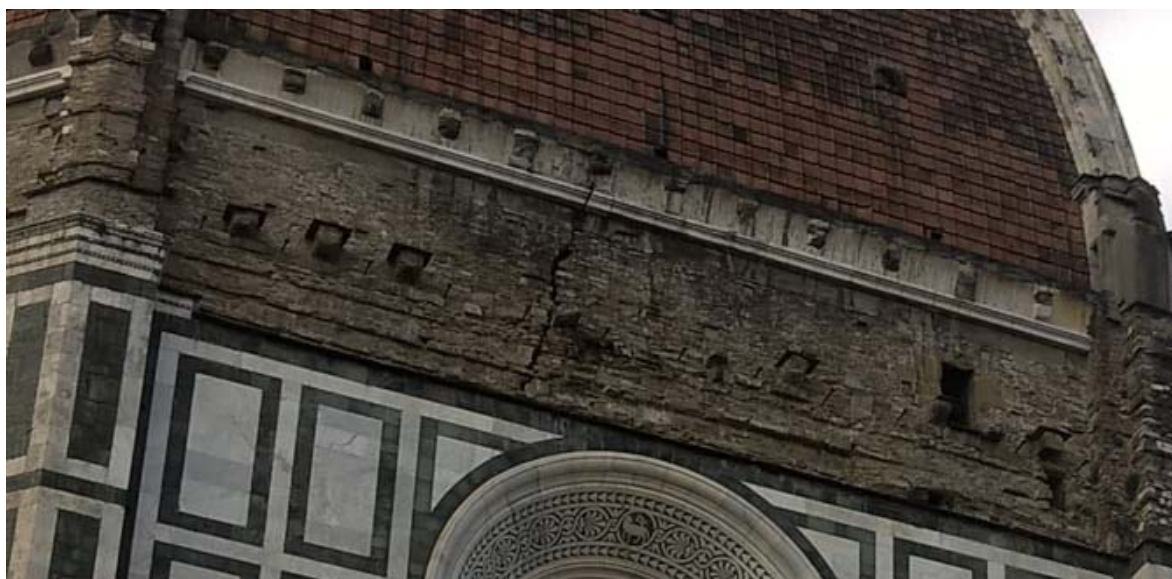
Figura 10. Rottura a “flessione” TRAVE-CATENA esterna
