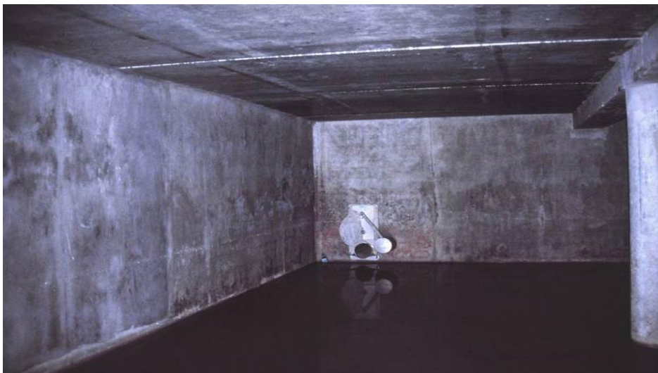
Bassins de rétention enterré
